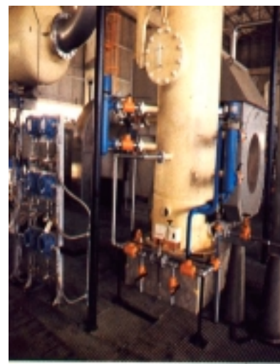
SEGURANÇA DE EQUIPAMENTO
