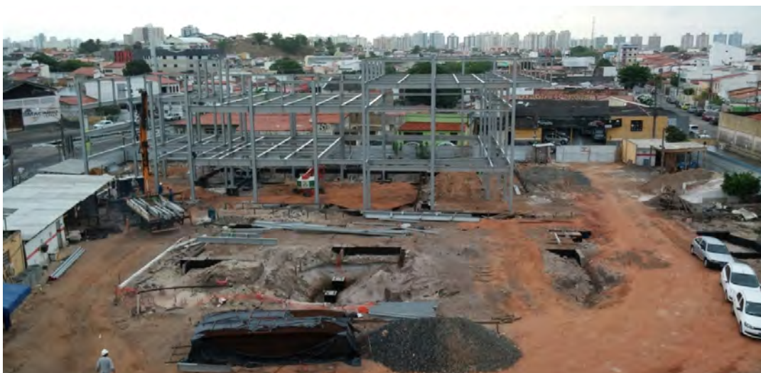
Figura 37: Canteiro das obras de ampliação e reestruturação do campus Aracaju (A) Fonte: DIPOP
